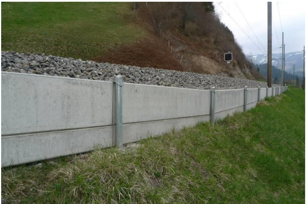
Das Bankettstabilisierungssystem Ribbert: unüberwindbares Hindernis, Trennung von Vegetations- und Schotterbereich. Ganz schlecht für Reptilien.
